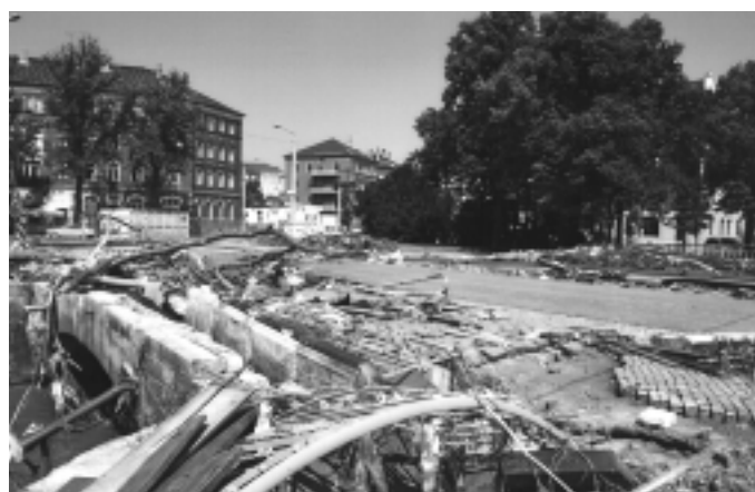
Von dieser Brücke über die Weißeritz blieb fast nichts übrig
