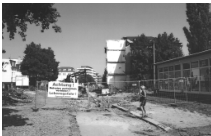
In diesem Haus starb ein 32-jähriger Mann, als mehrere Zimmer einstürzten.
