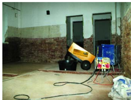
Eine Arztpraxis kurz nach dem Hochwasser in Pirna
