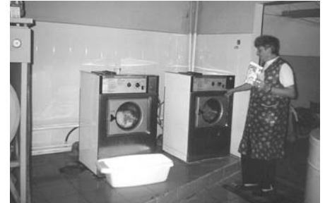
Die neue Wäscherei mit gelieferten Waschmaschinen und neuen Fliesen
