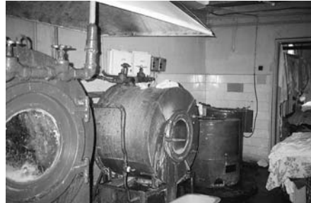
So sah die alte Wäscherei aus. Man erkennt die ungedichteten Türen und den enormen Wasser- und Seifenverlust.
