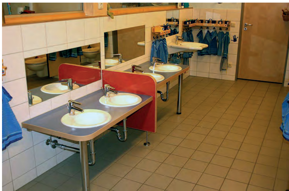
Abb. 2: Gut ausgestatteter Sanitärbereich einer Kindertagesstätte in Sachsen
