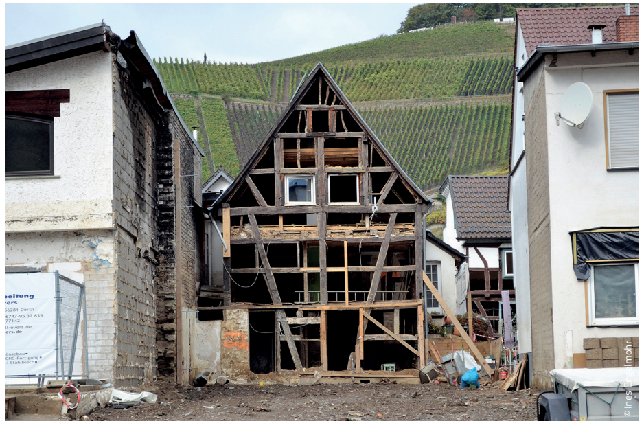
Entkernte kleine Fachwerkhäuser lassen erahnen, wie idyllisch das Ahrtal vor der Flutnacht war.
